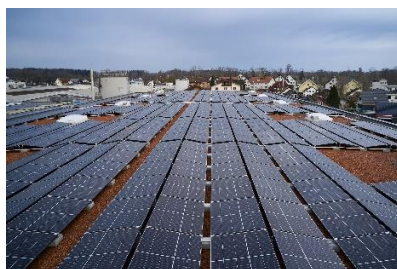
Tetto con moduli fotovoltaici
